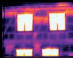
Fachwerkkonstruktion. In vielen der Gefächer fehlt die Dämmung, dies lässt sich an den wärmeren Farben erkennen.
